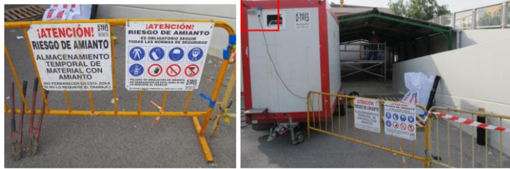
Vallado y señalización de obra, riesgo de amianto.
