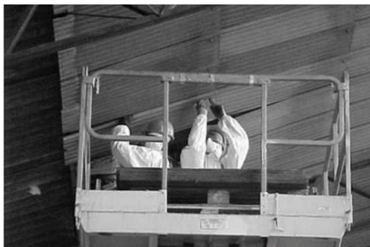
Figura 3. Desmontaje ganchos de anclaje de placas de fibrocemento (Calleja, A., Hernández, S. y Freixa, A. NTP 862: Orientaciones básicas de demolición, retirada o mantenimiento: ejemplos prácticos. INSST. 2010.)
