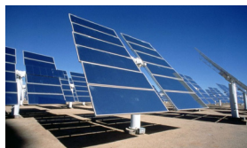
Paneles solares para la captación de energía solar
